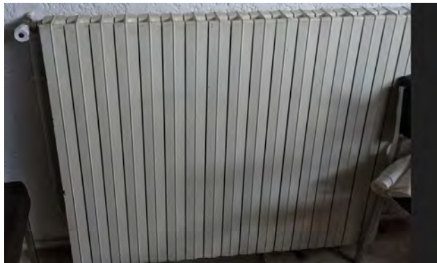
Radiateur acier présent dans le bâtiment
